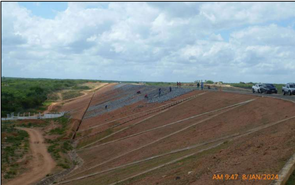
RH6 – BH Banabuiú – Barragem Cipoada – Recuperação do Talude de Jusante da Barragem
