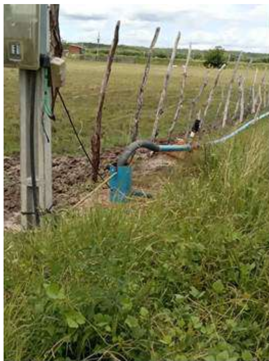
(l) captação subterrânea por poço profundo.
